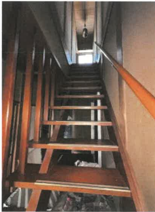
物件 2 階段の状況
