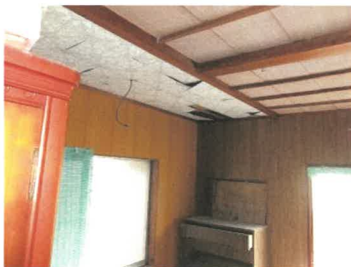
物件 2 建物の元の部分の南東角洋室の天井の損傷状況
