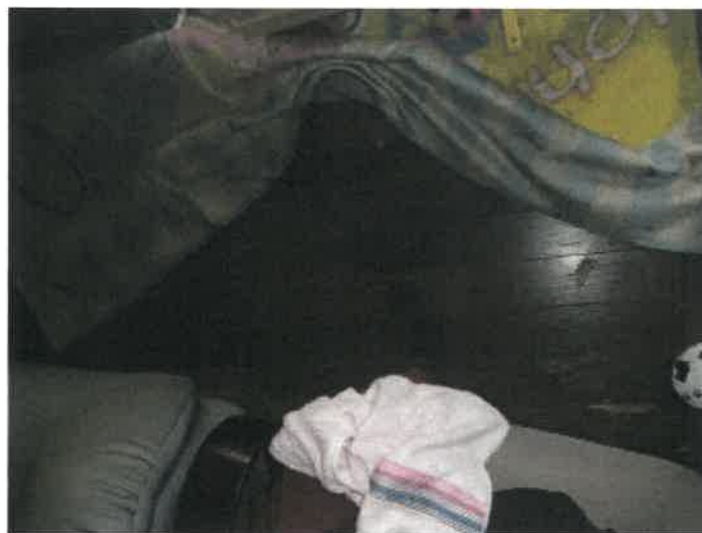
物件2建物の増築部分1階LDKの床のブカブカしている箇所の状況
