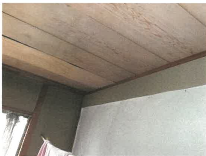
物件 2 建物の元の部分の西端東西廊下北側和室の天井の損傷状況
