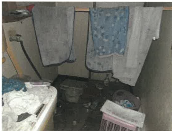
物件 2 建物の元の部分の北側中央付近洗面脱衣所の状況
