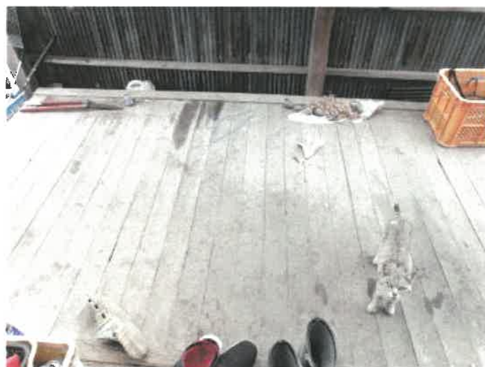
物件2建物の増築部分1階LDK南側の下屋付近の状況
