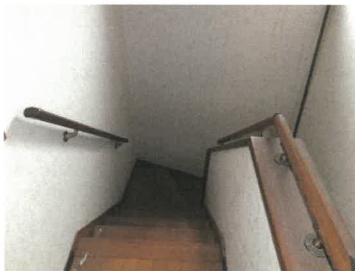
物件2建物の増築部分の階段の状況
