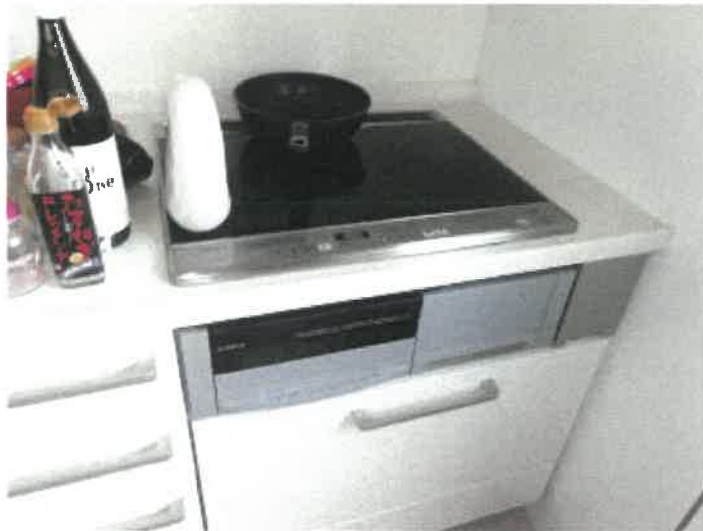
物件2建物の1階キッチンのIHクッキングヒーターの設置状況
