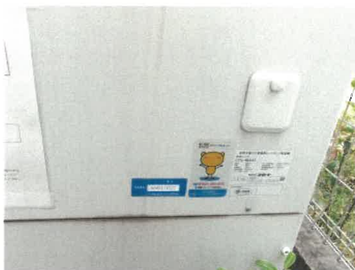
物件 2 建物の北側のエコキュートのリース票の状況
