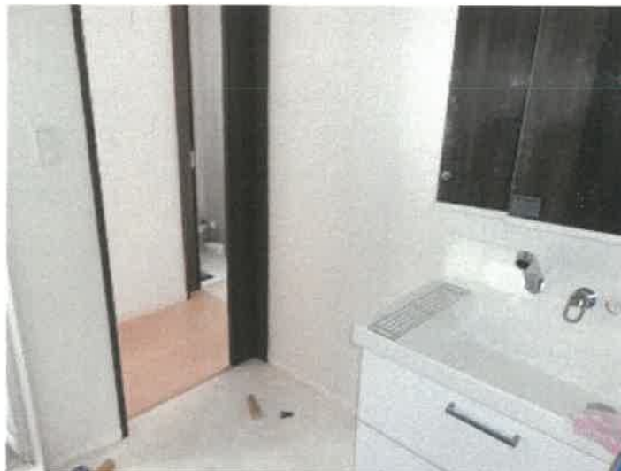
物件 2 建物の 1 階洗面脱衣所の状況
