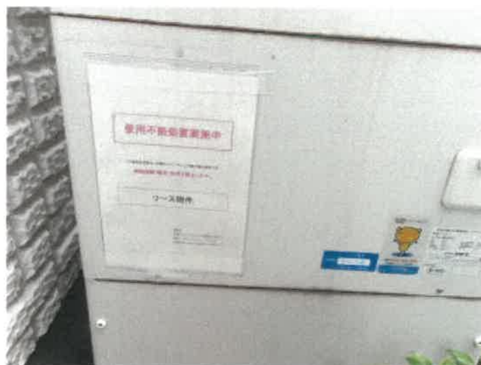
物件 2 建物の北側のエコキュートのリース票の状況
