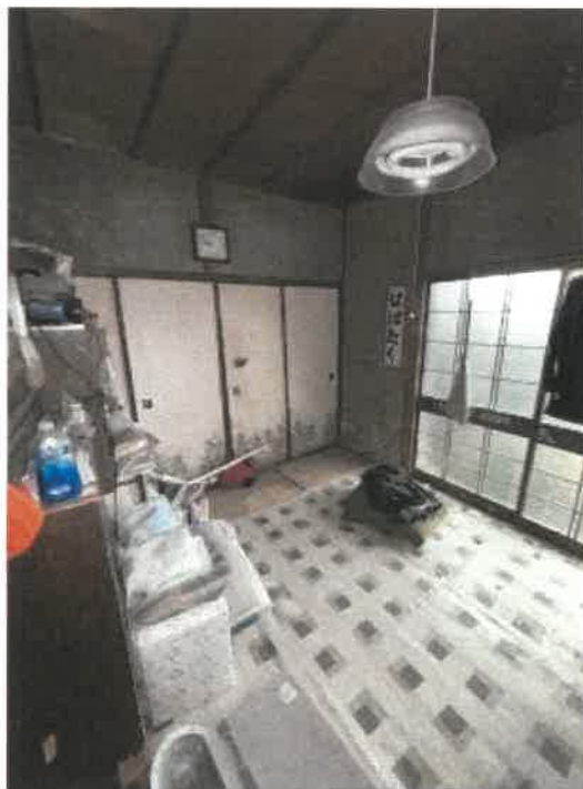
物件 2 北側和室の状況
