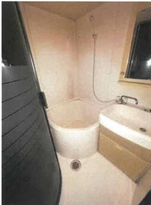
ユニットバスの状況
