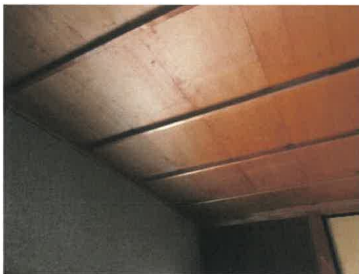
物件 2 建物の 2 階和室天井の雨漏り痕の状況
