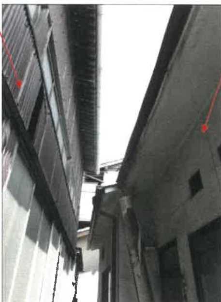
物件 2 建物と北側隣地（目的外土地 2 3 7 0 番 1）上の 目的外建物の相互の屋根が上空で越境している可能性のある状況
