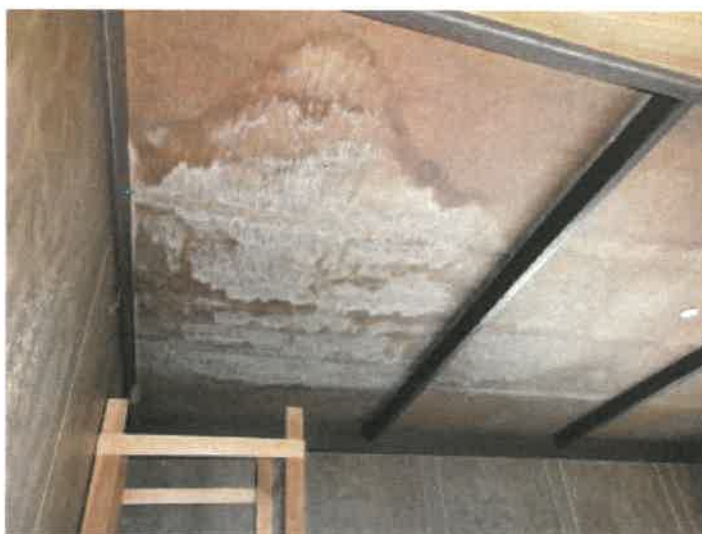
物件2建物の2階洋室天井の雨漏り痕の状況
