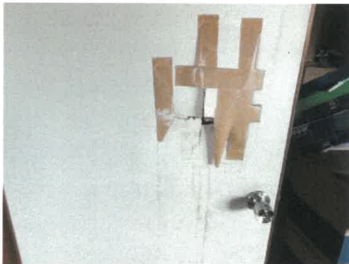
物件 8 主である建物部分の 2 階北側西端の洋室の扉の破損状況
