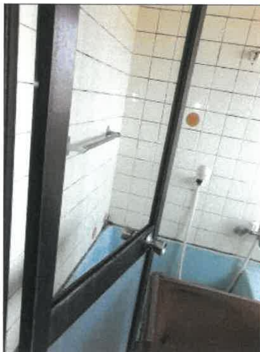
物件9建物部分の2階浴室出入口ドアのガラスが破損している状況
