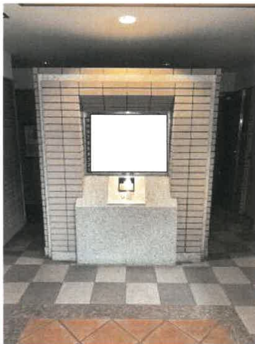
オートロック操作盤の状況
