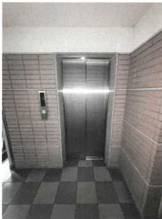
エレベーターの状況
