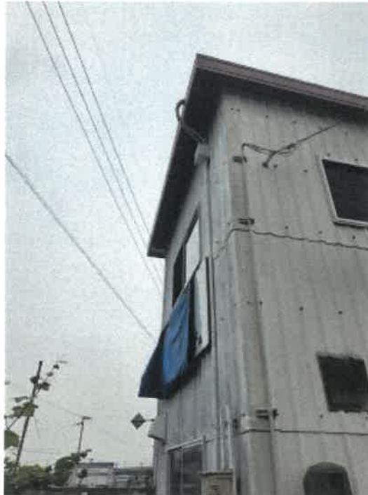
物件3 建物の屋根の太陽光発電パネルからの配線の状況
