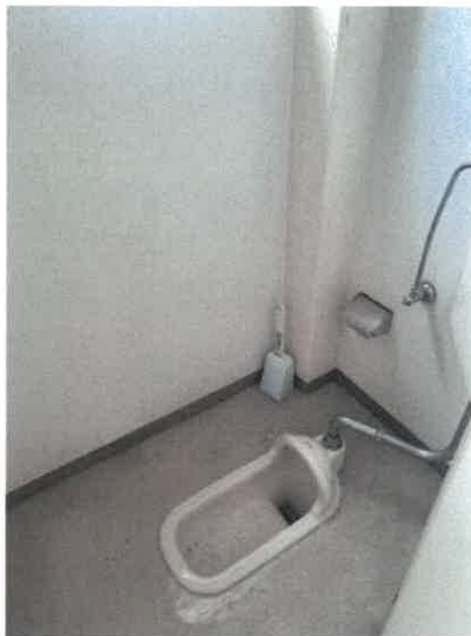
物件3建物の所有者側が占有しているエリア2階トイレの状況
