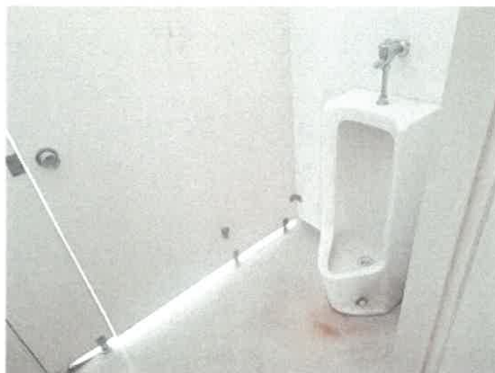
物件3建物の所有者側が占有しているエリア2階トイレの状況
