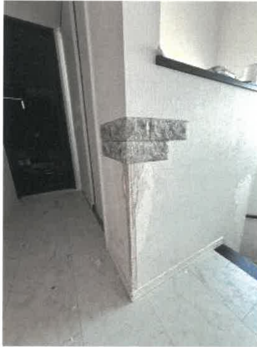
物件2 2階廊下の壁紙の状況
