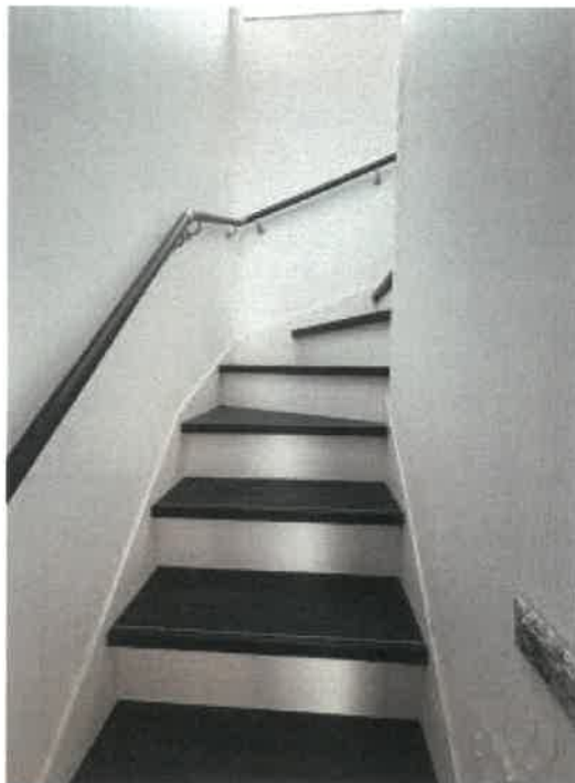
物件2 階段の状況
