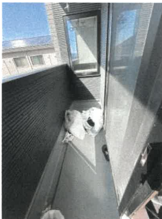
物件2 2階ベランダの状況
