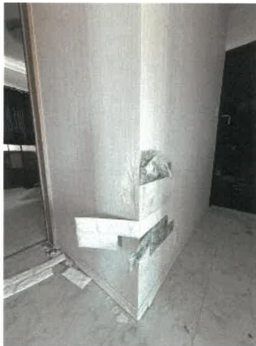
物件2 2階廊下の壁紙の状況
