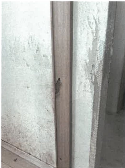
物件2 2階北東側洋室の入口の状況
