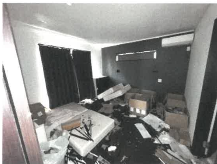
物件2 2階西側洋室の状況
