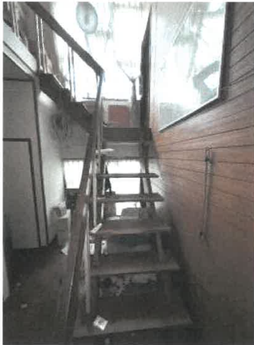
物件3 階段の状況
