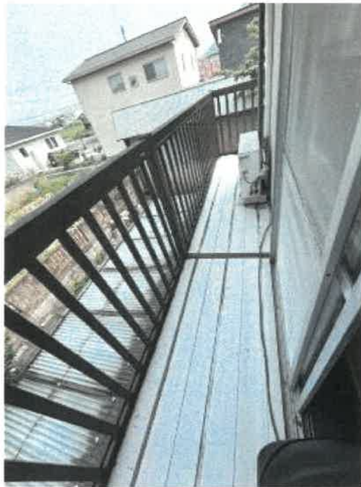
物件3 2階東側ベランダの状況
