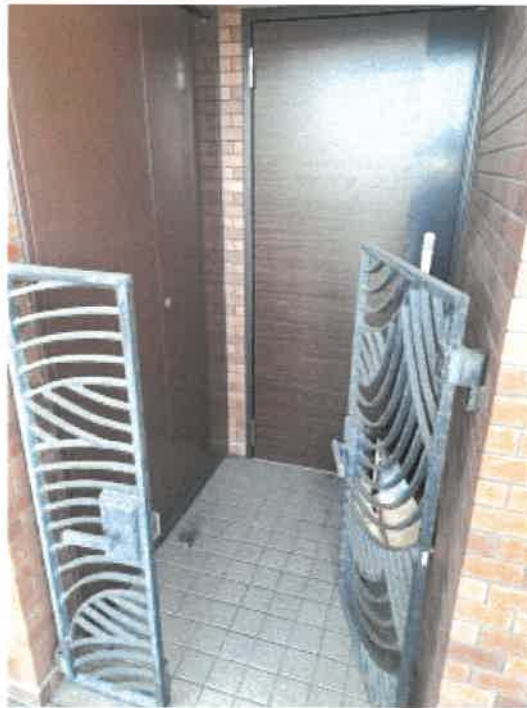
受命物件（４１０号室）の玄関付近の状況
