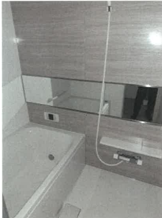
受命物件（410号室）の浴室の状況
