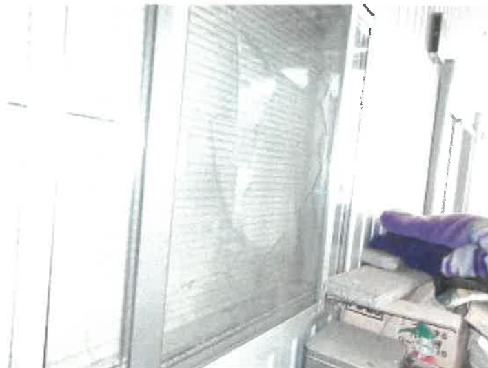
物件9主である建物の事務所部分の応接室の車庫側窓が割れている状況
