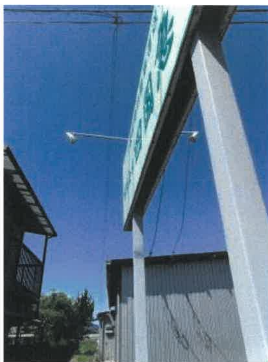
看板の照明が上空で隣地に越境している状況
