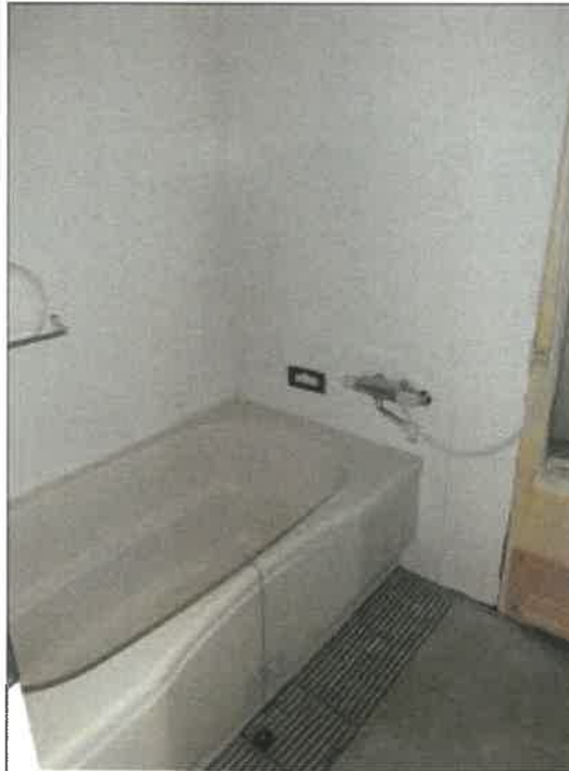
物件 9 未登記附属建物の浴室の状況
