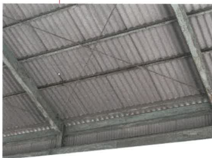
物件8建物の屋根の損傷状況
