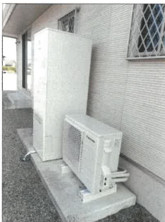
物件4建物の北側のエコキュートシステム設置の状況
