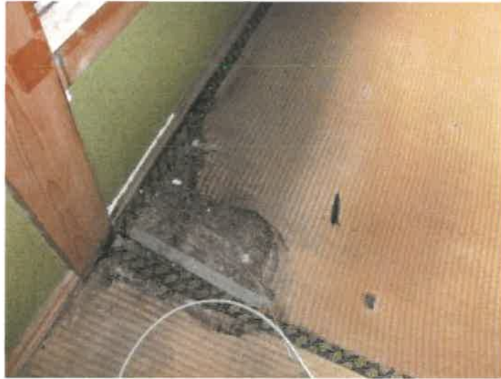
物件 5 建物の 2 階和室西角付近のシロアリによる被害と思われる部分の状況
