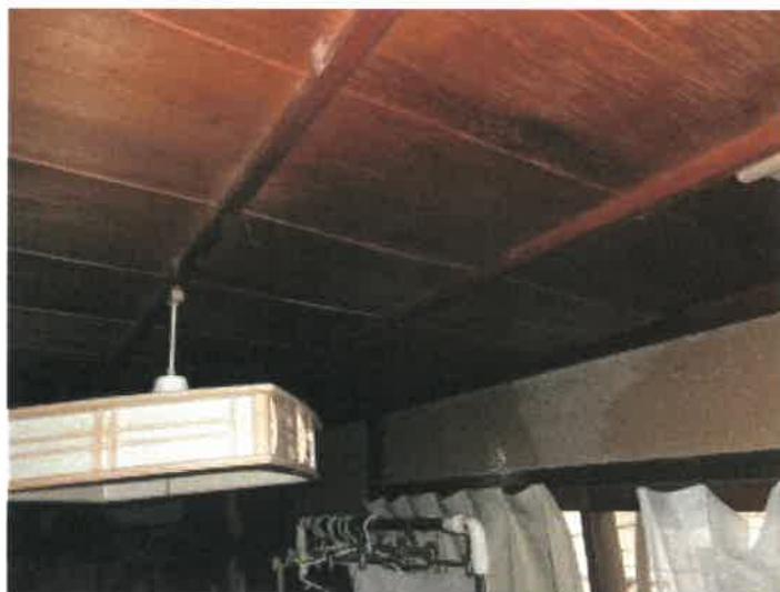
物件4主である建物の1階DK南西側和室（4．5畳）の 南西側和室（物置）の天井の雨漏り痕の状況
