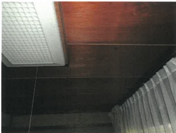
物件4主である建物の1階南角和室(8畳)の南西側縁側(物置)の天井の雨漏り痕の状況
