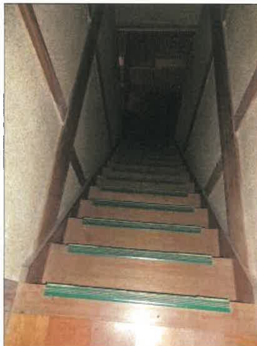
物件4主である建物の階段の状況
