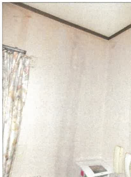
物件4 建物の2階居宅部分の洋室の壁の壁紙の汚れの状況
