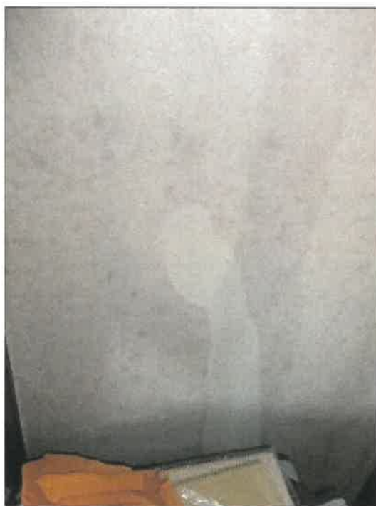
物件4建物の2階居宅部分の洋室の壁の壁紙の損傷状況
