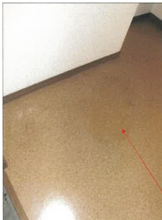
物件5建物102号室玄関の床のシミの状況
