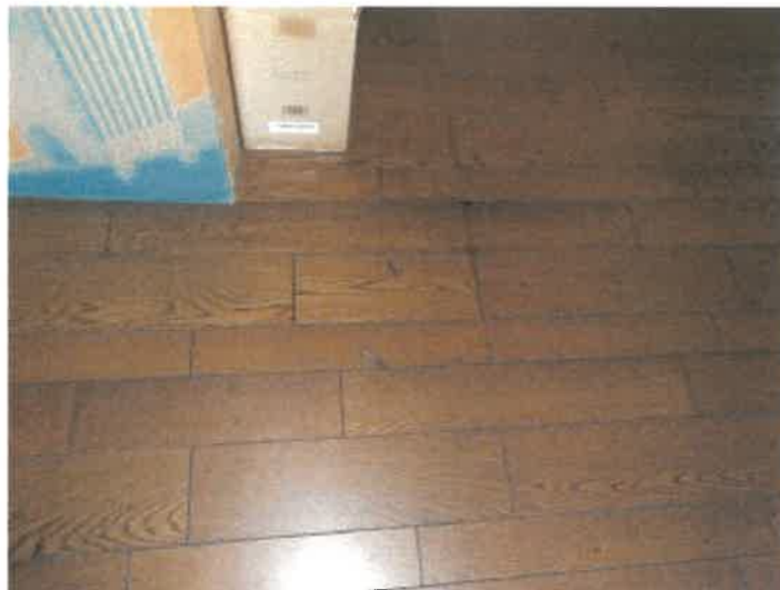
物件4 建物の2階居宅部分のDKの床の損傷状況
