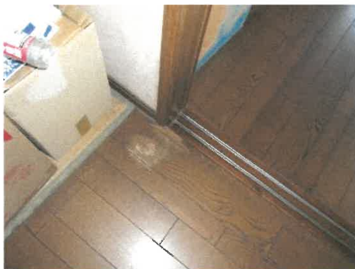
物件4 建物の2階居宅部分の洋室のDK側の床の損傷状況
