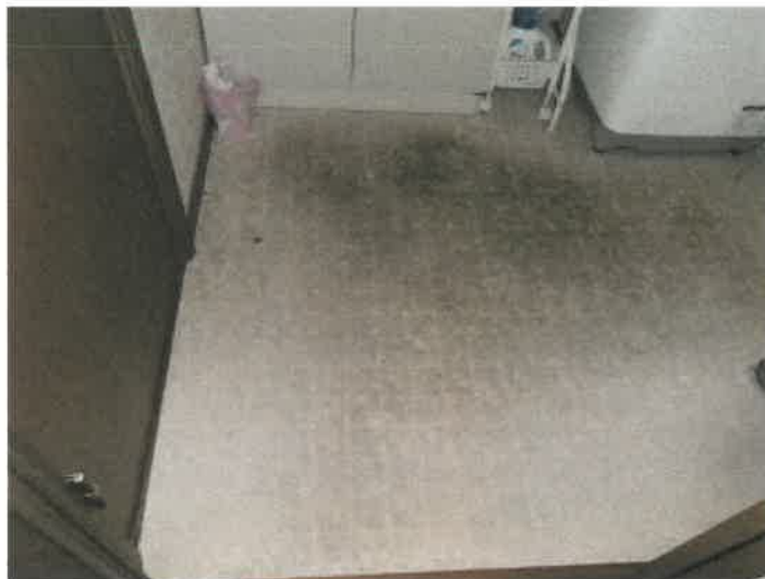
物件 6 建物 2 0 2 号室洗面脱衣所の床の汚れの状況
