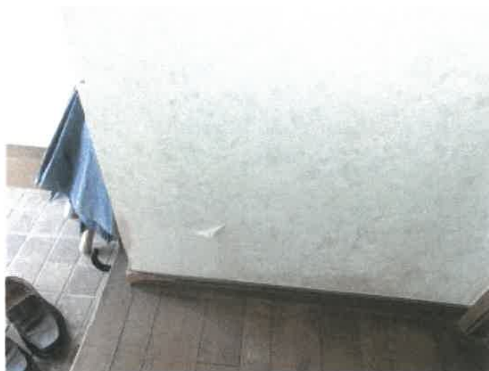
物件4建物の2階居宅部分の玄関付近壁の壁紙の破損の状況
