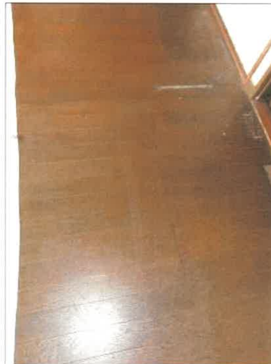
受命物件（301号室）のLDKのフローリングの損傷状況
