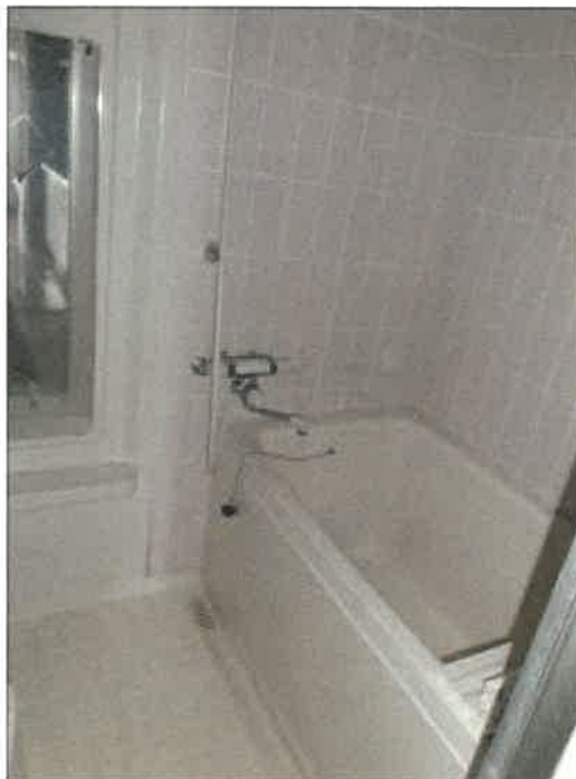
受命物件（301号室）の浴室の状況
