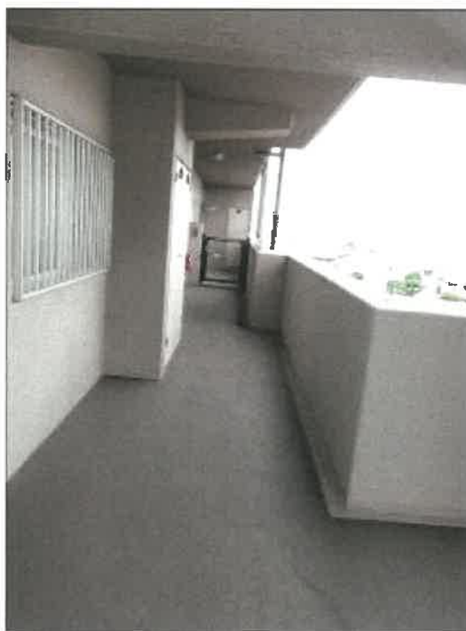
受命物件（301号室）の前付近の外廊下の状況
