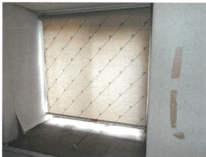
受命物件（301号室）のLDKの北西側出窓付近の状況
