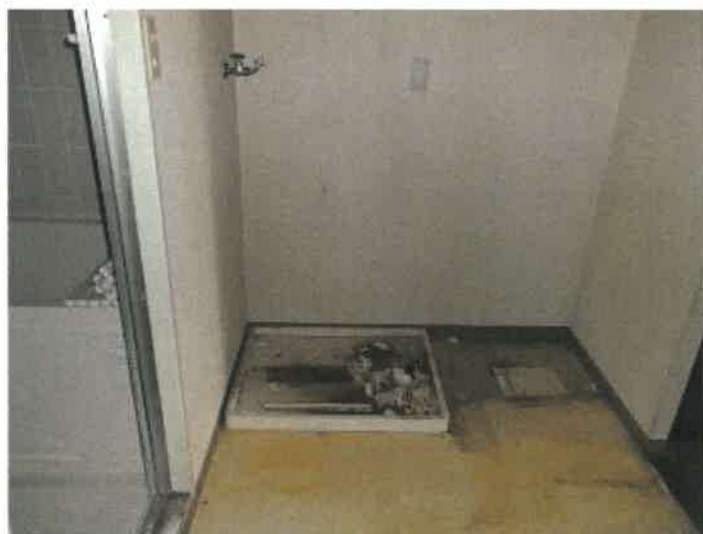
受命物件（301号室）の洗面脱衣所の状況
