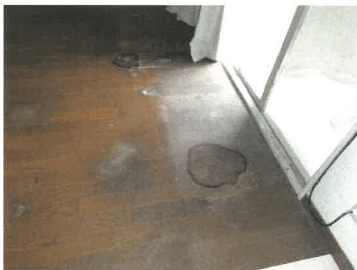
受命物件（301号室）のLDKのフローリングの損傷状況
