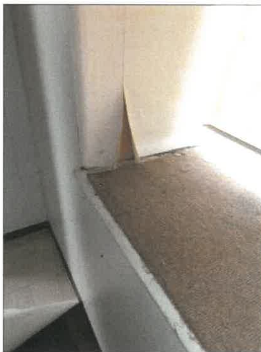
受命物件（301号室）のLDKの北西側出窓付近の壁紙の損傷状況
