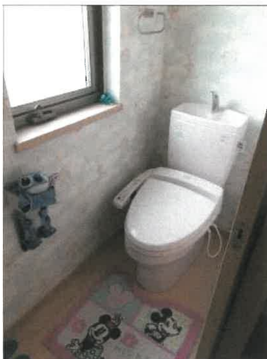
物件 3 建物の 2 階のトイレの状況
