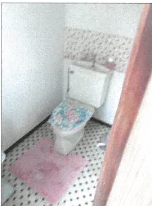
物件 2 建物の 1 階西角のトイレの状況
