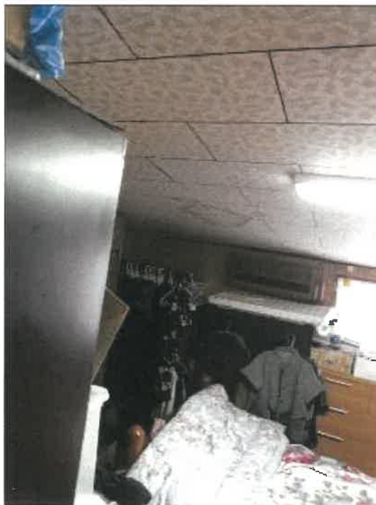
物件 2 建物の 1 階北東側DK南東側洋室の天井の雨漏り痕の状況
