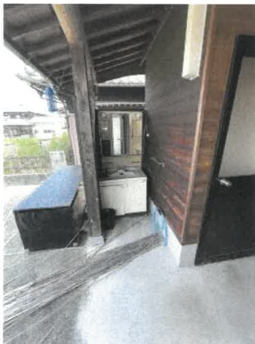
物件2 トイレ北西側手洗場の状況
