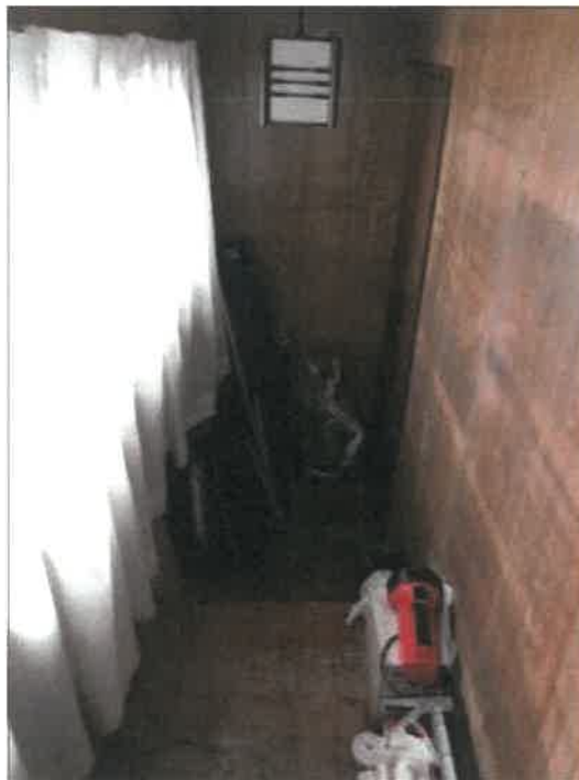
物件2建物の2階東側の北廊下の状況
