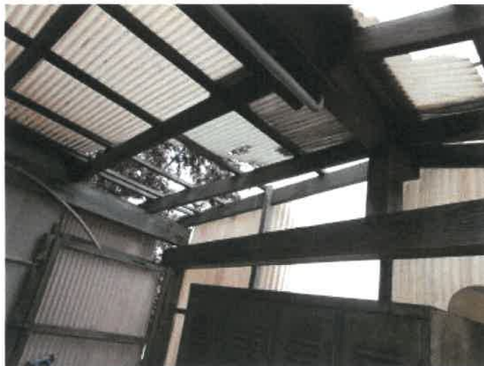
物件2 建物東側倉庫（増築部分）北端屋根の損傷状況
