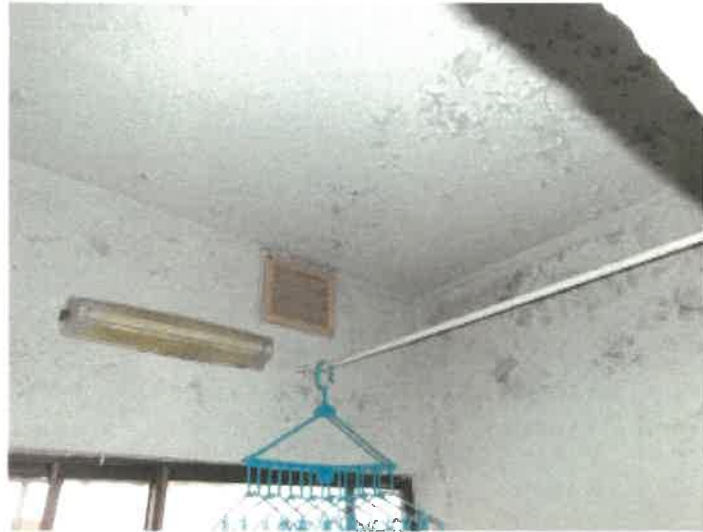
物件2建物の1階浴室の壁の損傷状況
