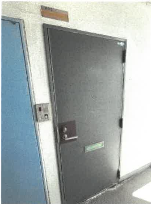
203号室入口ドアの状況
