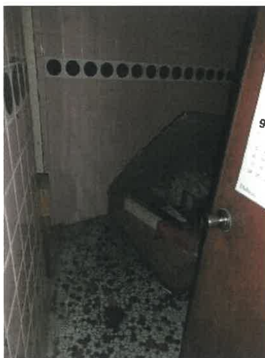
物件 4 建物の 1 階南東角浴室の状況
