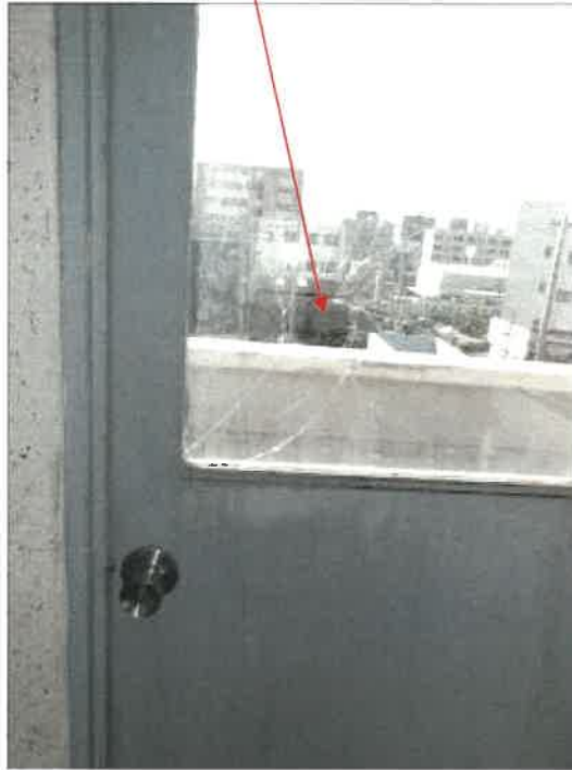
物件 2 建物の 4 階屋上への出入口ドアのガラスが損傷している状況
