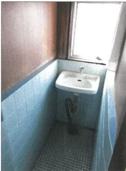
物件 4 建物の 2 階事務所の洗面所の状況
