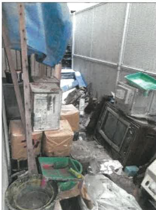
物件4建物の1階浴室北側の状況
