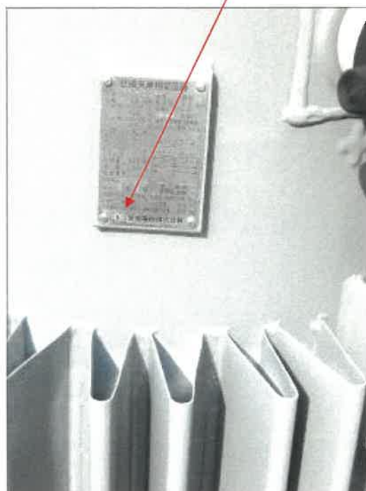
物件 2 建物の西側電柱に設置しているトランスの製品記号番号の状況
