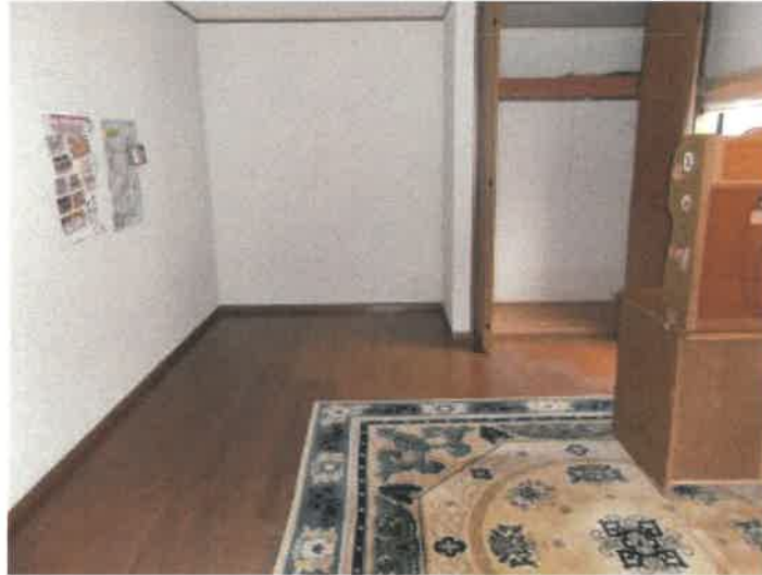
物件 2 建物の 2 階北端洋室の状況
