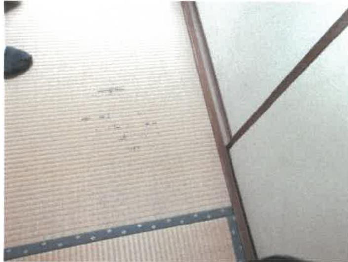
物件3主である建物の西側南和室畳のシロアリ被害の状況
