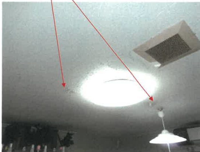
物件3主である建物DK天井の損傷状況
