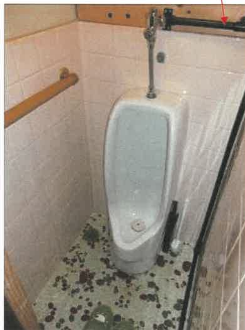
物件 3 主である建物トイレの状況
