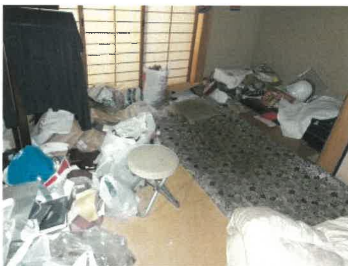
物件2建物の1階南側の西側和室の状況
