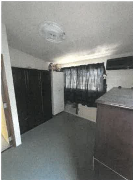
物件3 2階北側洋室の状況
