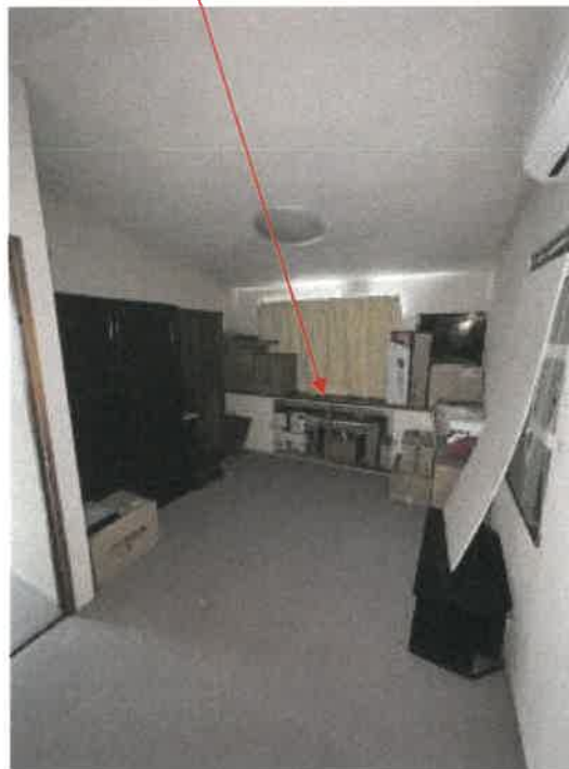
物件3 2階南側洋室の状況
