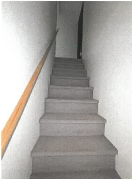
物件3 階段の状況
