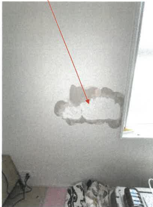
物件2 1階LDK壁の状況
