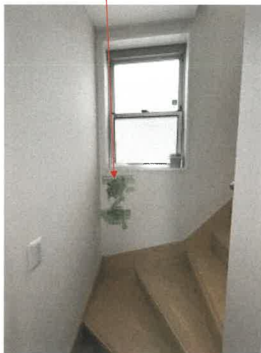
物件2 階段の状況
