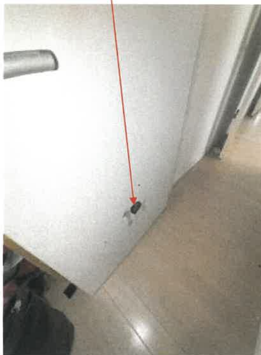
物件2 2階東側洋室ドアの状況
