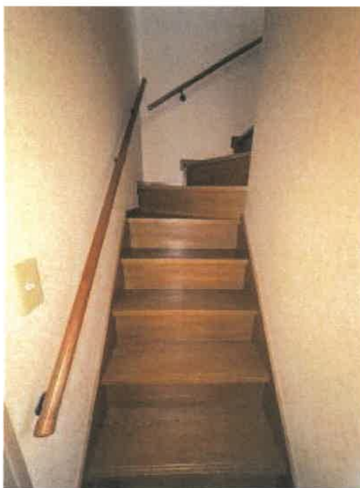
物件2 階段の状況
