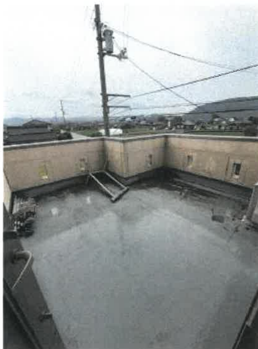
物件 2 2階バルコニーの状況
