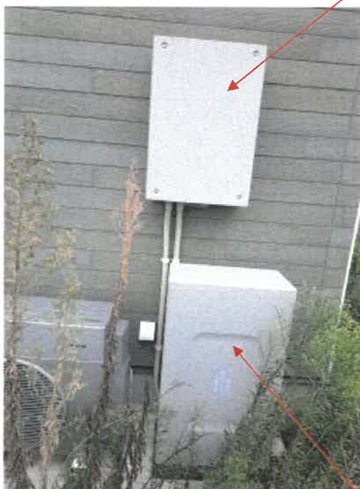
太陽光発電システムの設置状況
