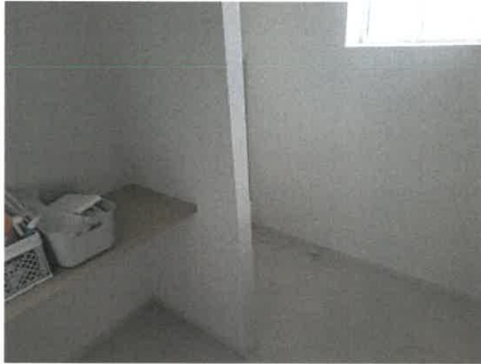
物件 2 建物の洗面脱衣所の状況
