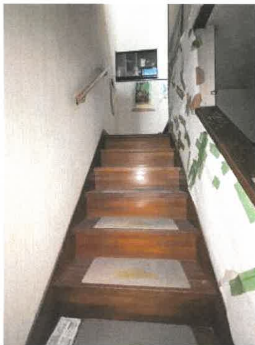
物件2 階段の状況
