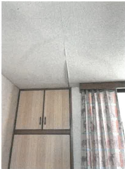
物件 2 2階北側洋室の雨漏り跡の状況
