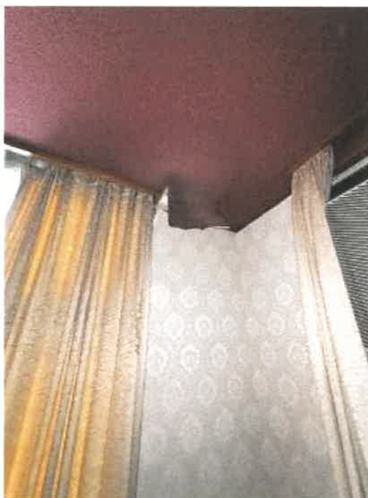
物件 2 2階東側洋室の雨漏り跡の状況
