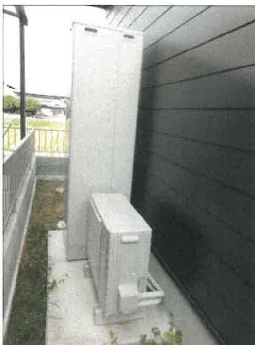
物件 3 建物西側エコキュート設置の状況
