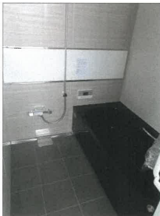
物件 3 建物の浴室の状況
