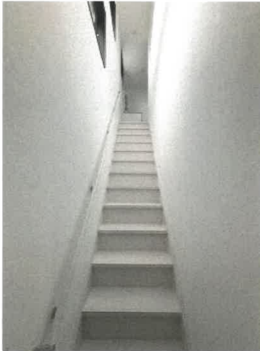
物件3 階段の状況
