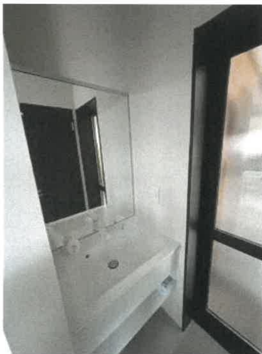
物件3 1階洗面所の状況
