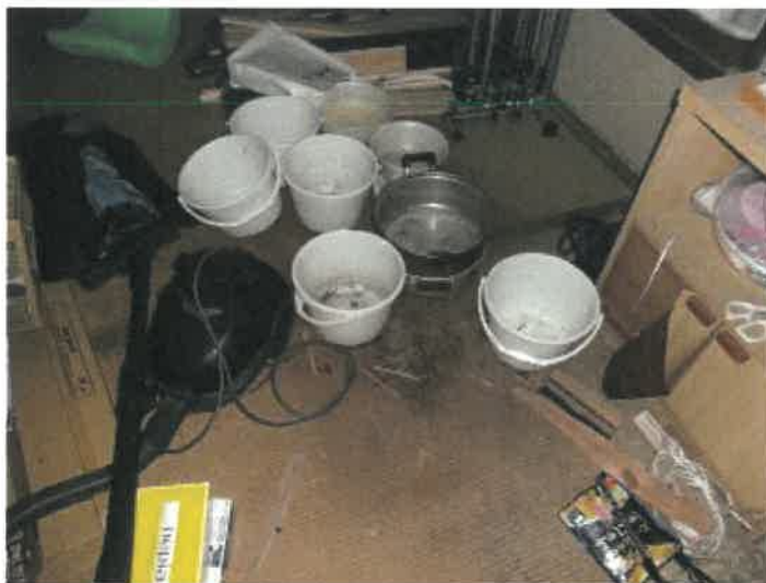
物件4主である建物の1階DK南西側和室（4．5畳）の雨漏りの状況
