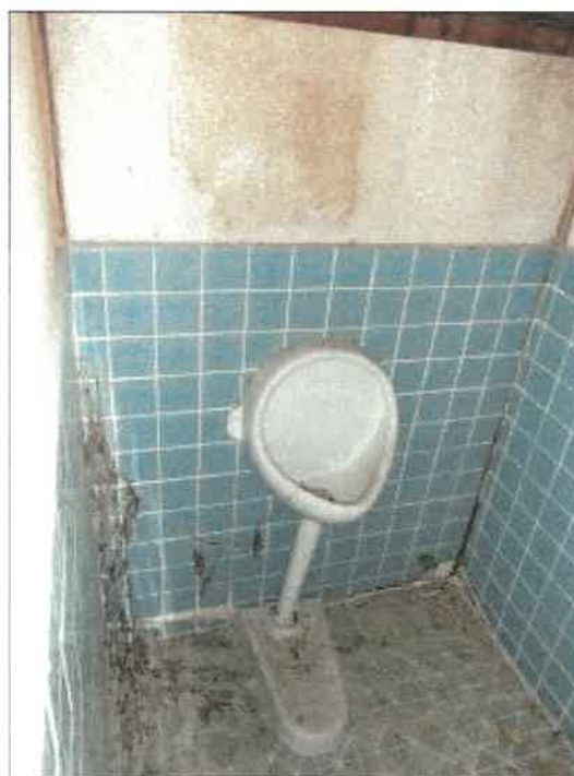
物件4主である建物の1階南西角のトイレの状況
