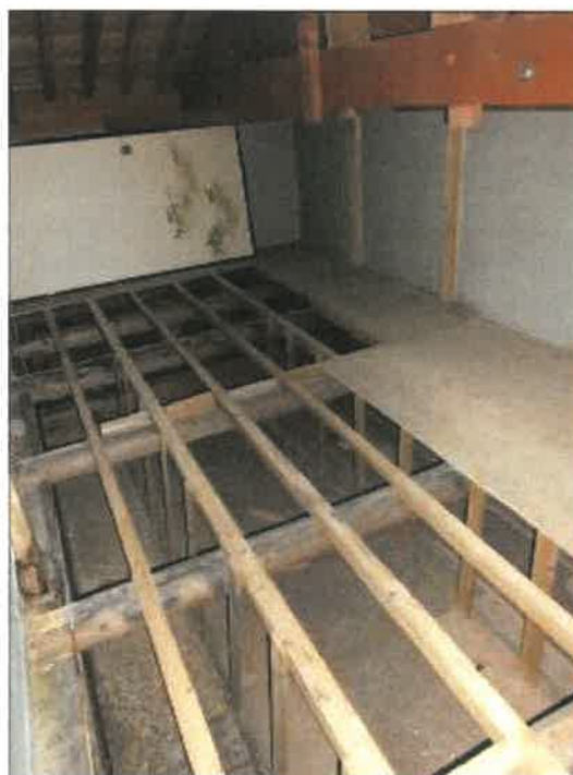
物件 5 建物の 2 階和室南西側屋根裏スペースのシロアリによる被害と思われる部分の状況
