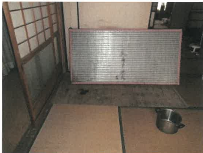
物件 5 建物の 1 階南西側和室の畳の雨漏りによる被害の状況
