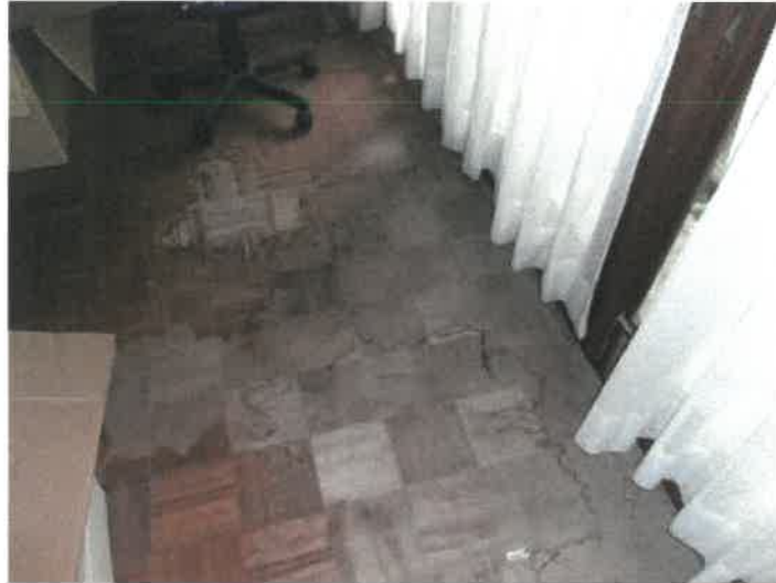
物件4主である建物の1階南角和室(8畳)の南西側縁側(物置)の床の損傷状況
