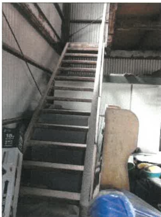
物件 4 建物附属建物符号 1 の階段の状況
