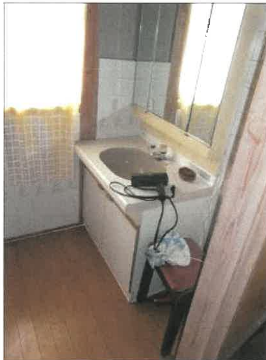
物件5建物の1階手洗いの状況
