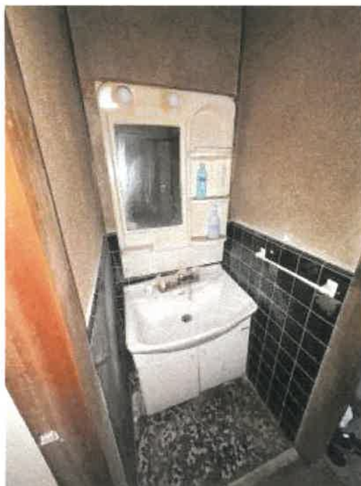
物件3 1階洗面台付近の状況
