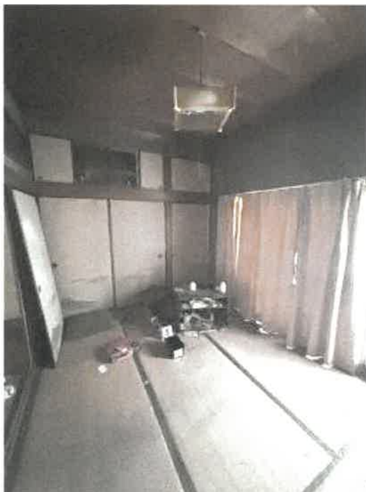
物件3 1階北西側和室の状況
