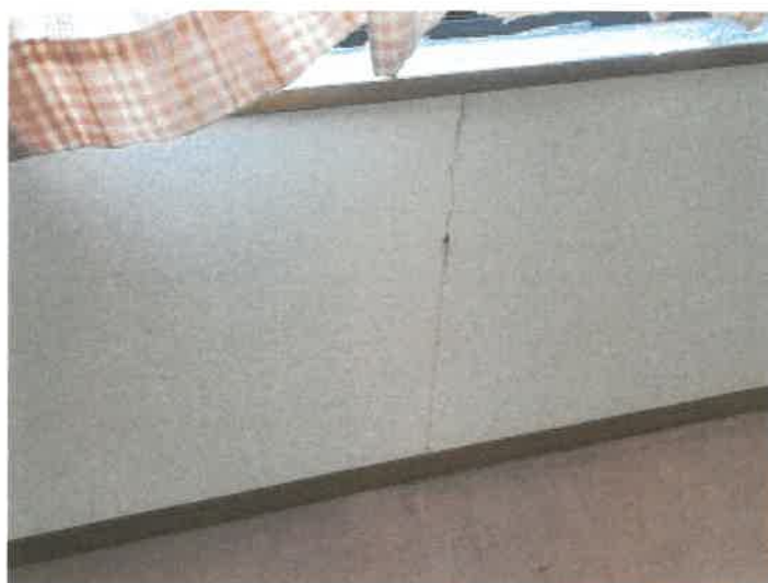
物件2建物の3階東側洋室の東側壁の損傷の状況
