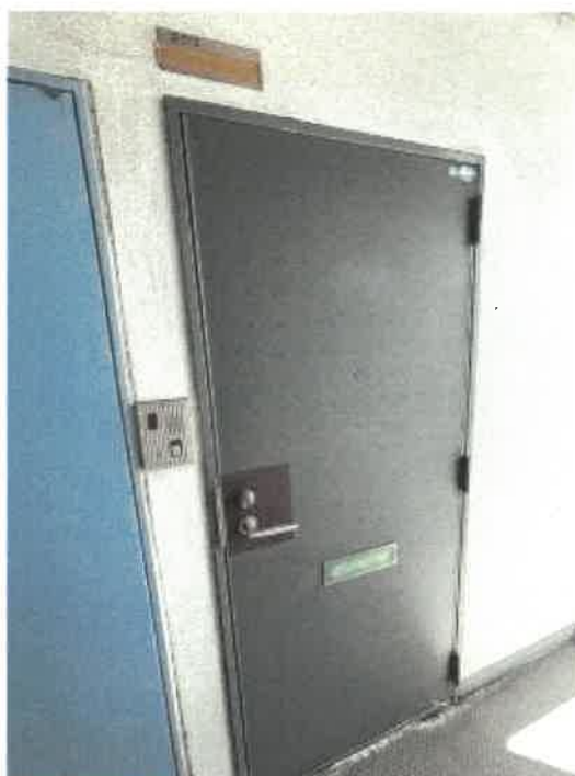
203号室入口ドアの状況
