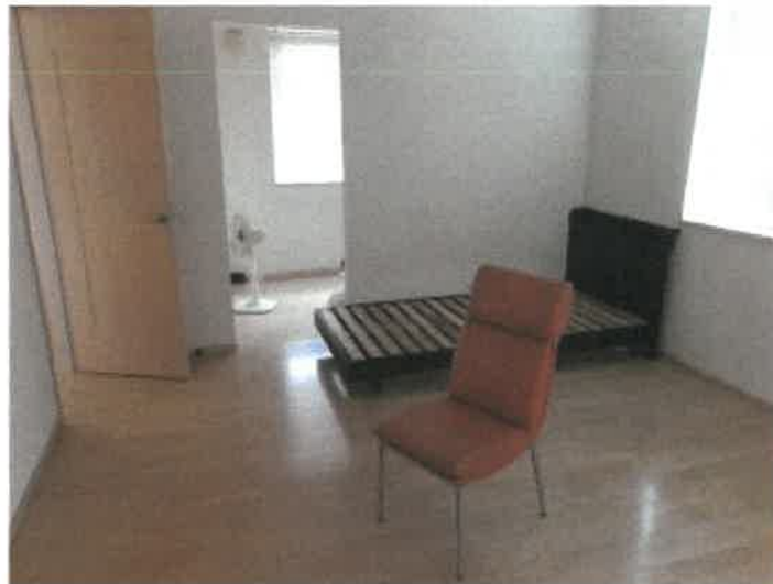
物件 3 建物の 2 階北東側端の洋室の状況
