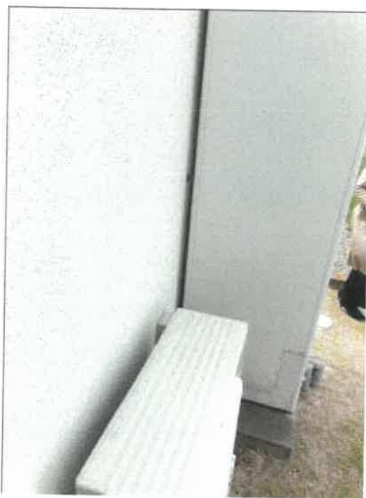
物件3建物北東側のエコキュート設置状況
