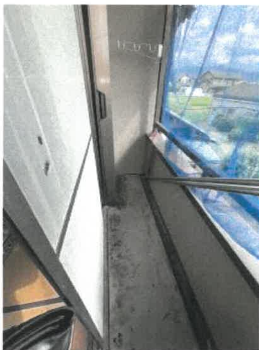
物件3 2階ベランダの状況
