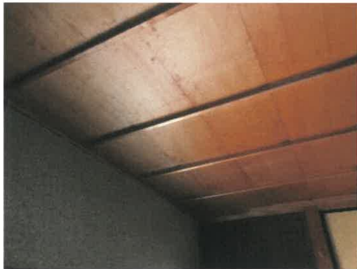
物件 2 建物の 2 階和室天井の雨漏り痕の状況
