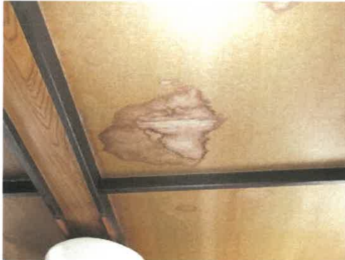
物件2建物の2階洋室天井の雨漏り痕の状況
