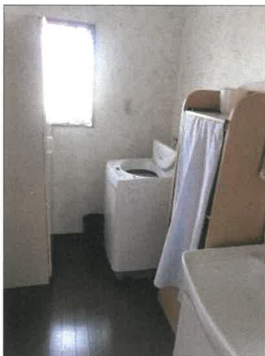
物件2 建物の1階洗面脱衣所の損傷状況
