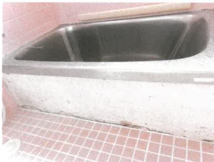
物件 2 建物の 1 階浴室の損傷状況
