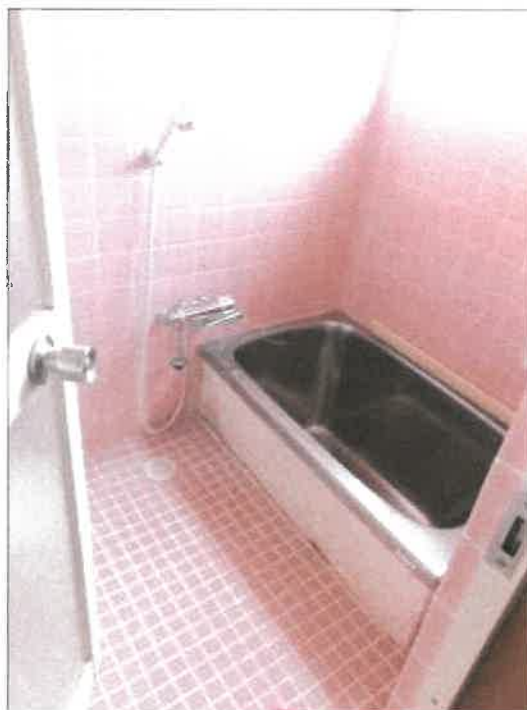
物件 2 建物の 1 階浴室の損傷状況
