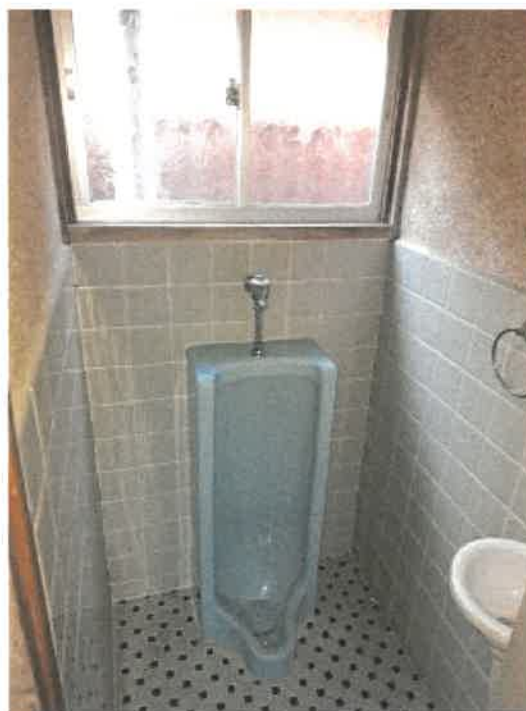
物件 4 附属建物符号 1 部分のトイレの状況
