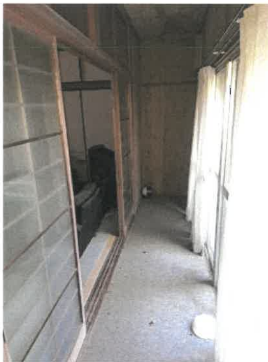
物件4附属建物符号1部分の玄関前東西廊下の状況
