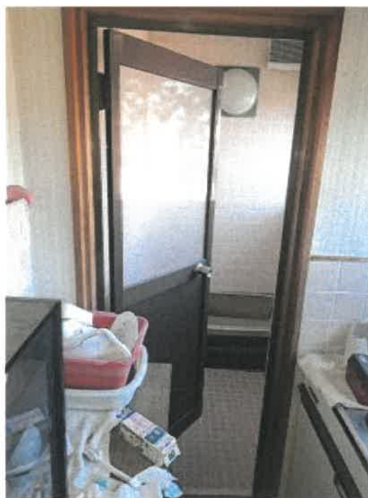
物件4 附属建物符号1 部分の東端キッチン北の浴室出入口付近の状況
