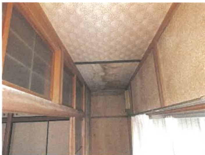
物件4附属建物符号1部分の玄関前東西廊下の天井の雨漏り痕の状況
