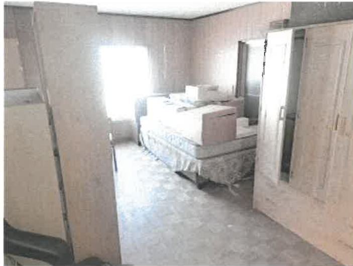
物件 4 主である建物部分 2 階東側洋室（増築部分）の状況
