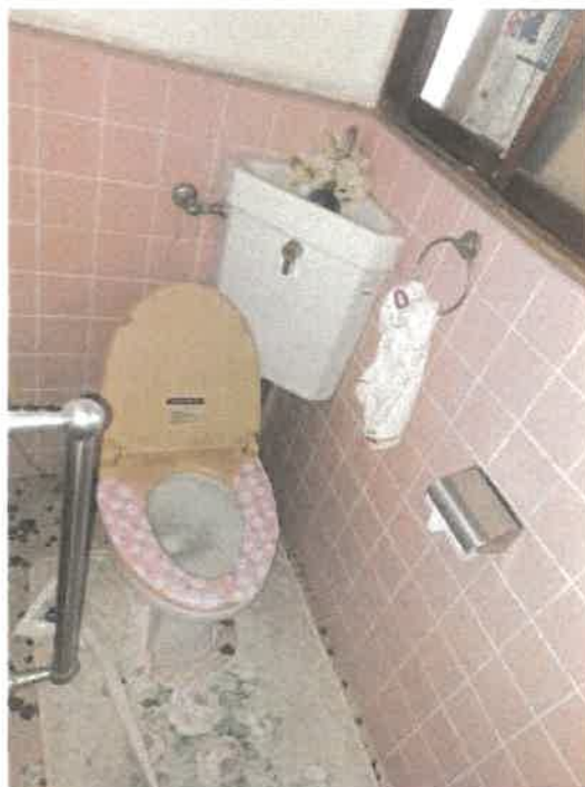
物件4主である建物部分1階南東角のトイレの状況
