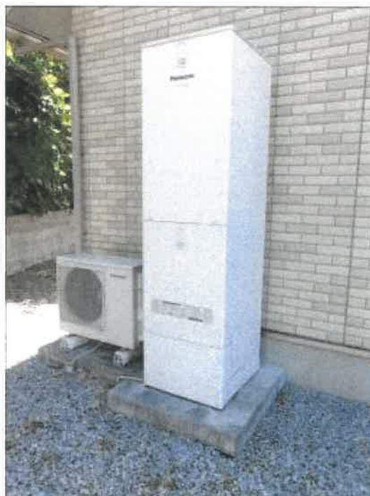
物件 2 建物北東側のエコキュート設置の状況
