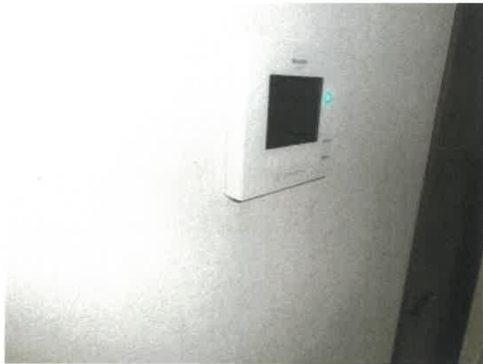
物件 2 建物の 1 階 L D K の太陽光発電システムのコントロールパネルの状況
