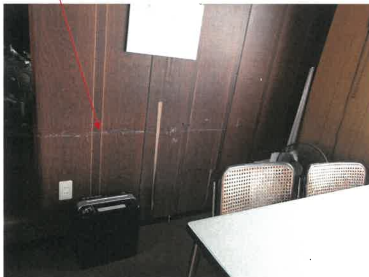
物件3附属建物符号1の事務所部分壁の状況
