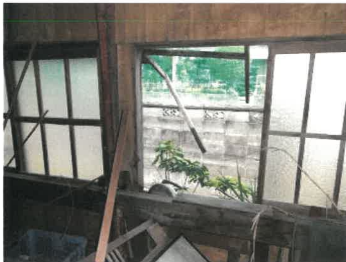
物件3主である建物南西側端から2区画目の作業所北西側窓の損傷状況
