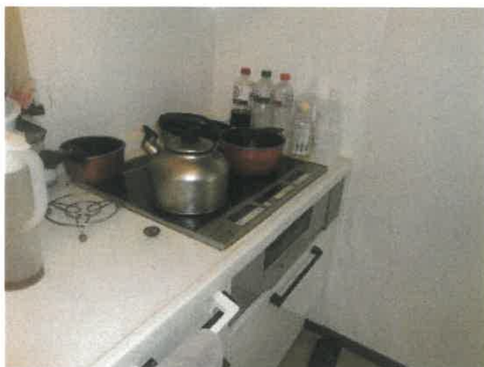
物件2建物の1階LDKのIHクッキングヒーター設置状況
