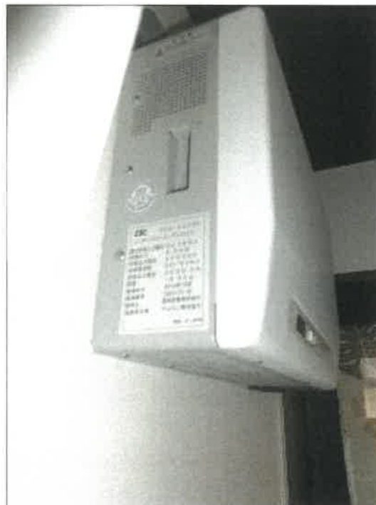
物件 2 建物の 1 階 LDK のキッチン付近の太陽光発電パワーコンディショナーの状況
