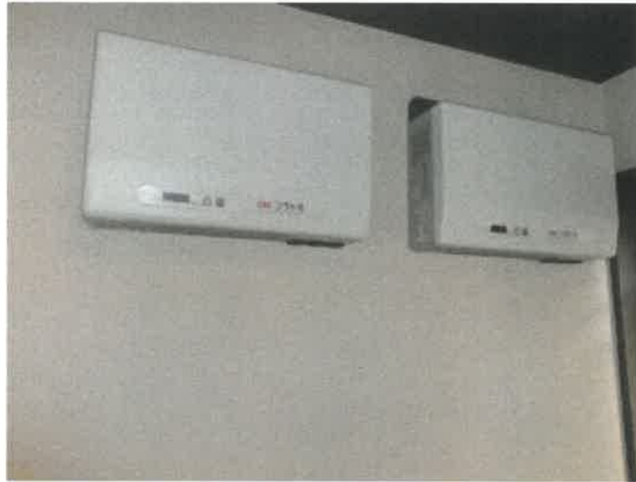
物件 2 建物の 1 階 LDK のキッチン付近の太陽光発電パワーコンディショナーの状況
