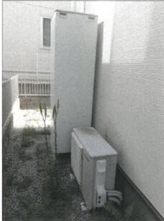
物件2建物北東側のエコキュートの設置状況
