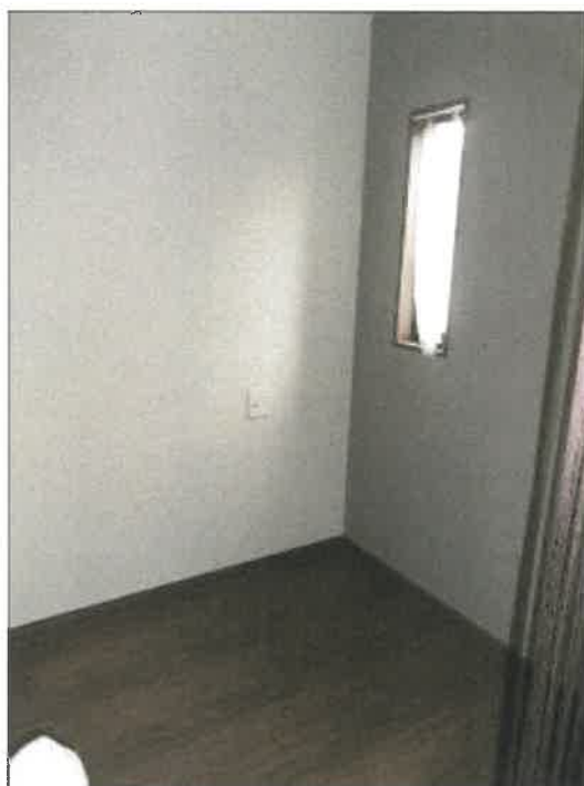
物件 2 建物の 2 階南西側洋室東側クローゼットの状況
