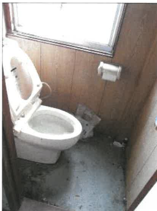
物件2 建物の元の部分の北側中央付近浴室東側トイレの状況
