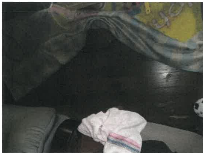
物件2建物の増築部分1階LDKの床のブカブカしている箇所状況
