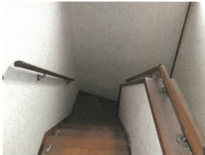
物件 2 建物の増築部分の階段の状況
