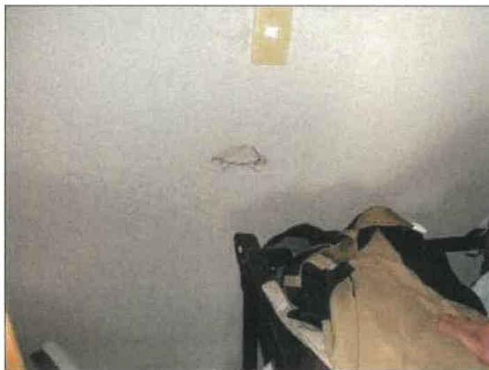
物件2建物の増築部分1階北側和室南側壁の損傷の状況
