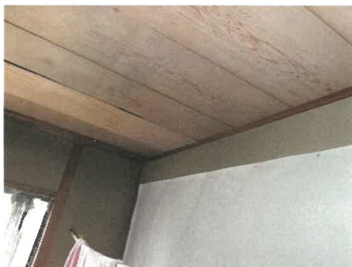
物件 2 建物の元の部分の西端東西廊下北側和室の天井の損傷状況
