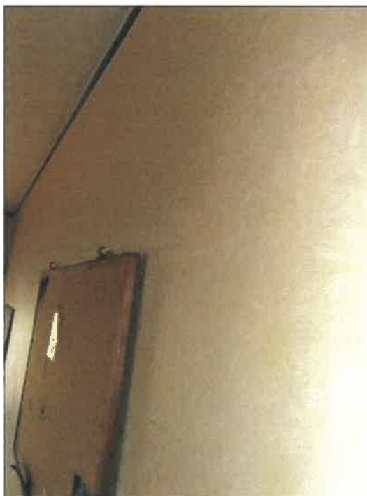
物件 2 建物の増築部分の 2 階南側東洋室壁のタバコのヤニ被害状況
