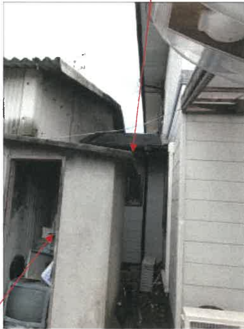
物件 2 の元の建物南東角増築部分付近の状況
