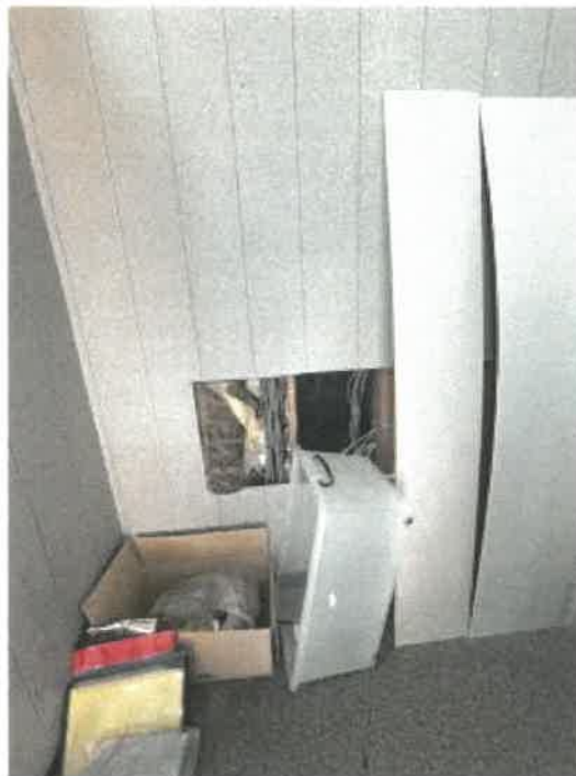
物件2 階段踊り場の状況
