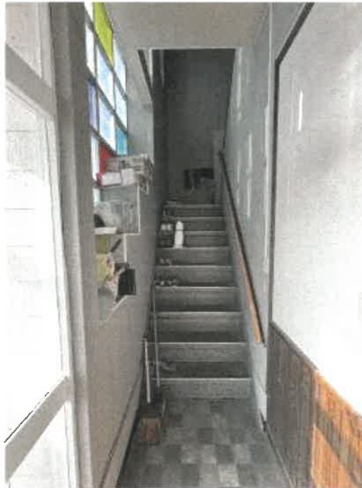
物件2 階段の状況
