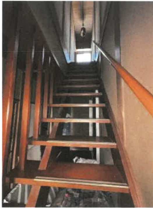
物件 2 階段の状況
