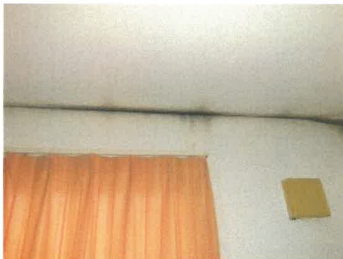
物件 2 建物の 2 階北東側洋室の天井の南東角のカビの状況
