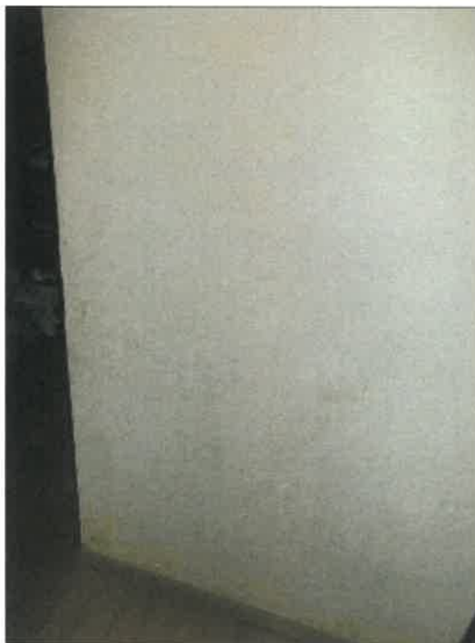
物件 2 建物の 1 階階段付近壁の汚れの状況
