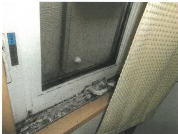
物件2建物の2階北東側洋室の東側窓の湿気による損傷状況
