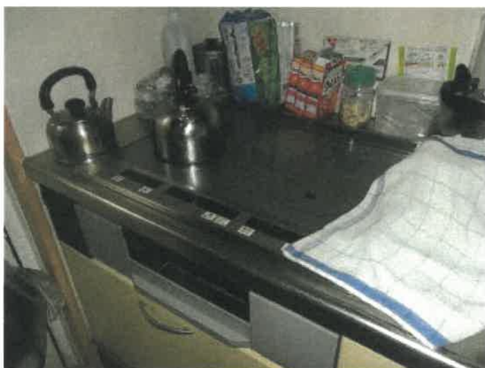
物件 2 建物の 1 階キッチンの IH クッキングヒーター設置状況
