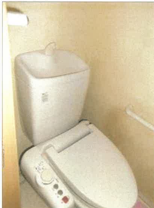
物件 2 建物の 1 階トイレの状況 汚れ、損傷
