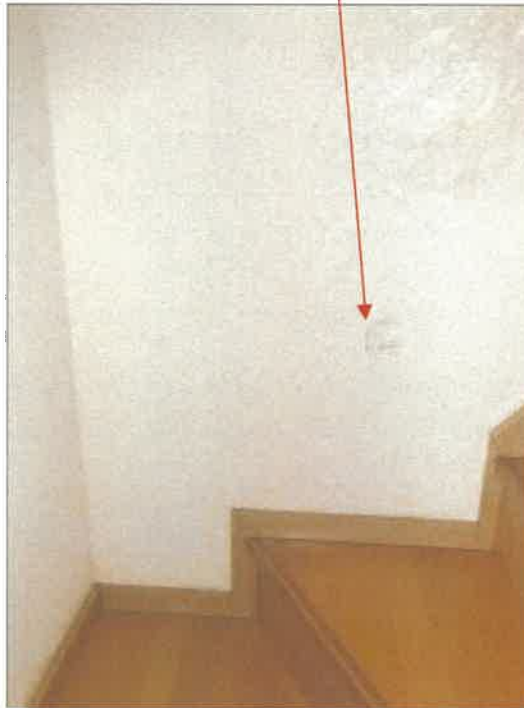
物件 2 建物の階段の壁の損傷個所の状況
