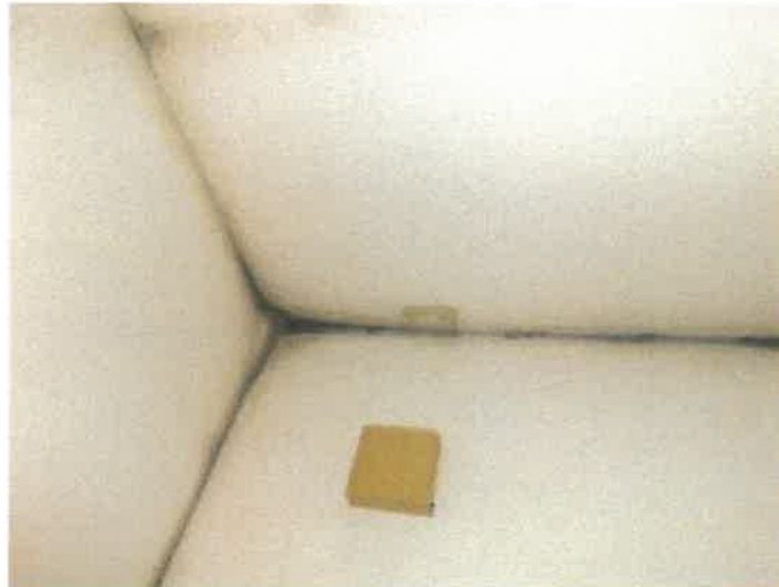
物件 2 建物の 2 階北東側洋室の天井の北東角のカビの状況
