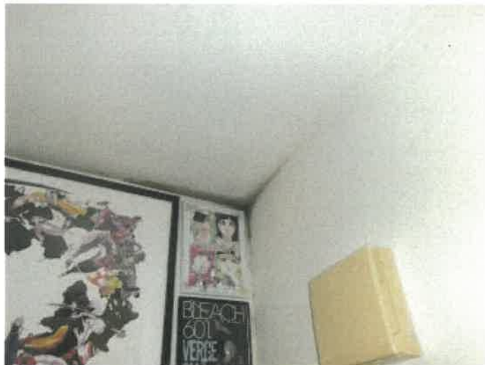
物件 2 建物の 2 階南東側洋室の天井の南東角のカビの状況
