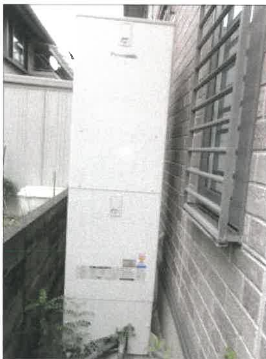
物件2建物北側のエコキュート設置の状況
