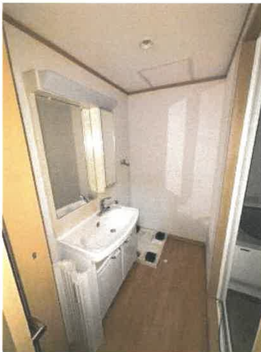
物件4 東側居宅1 階洗面所付近の状況
