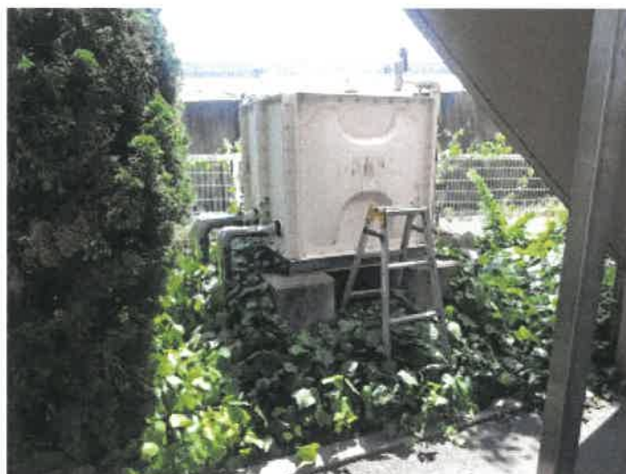
受水槽の状況
