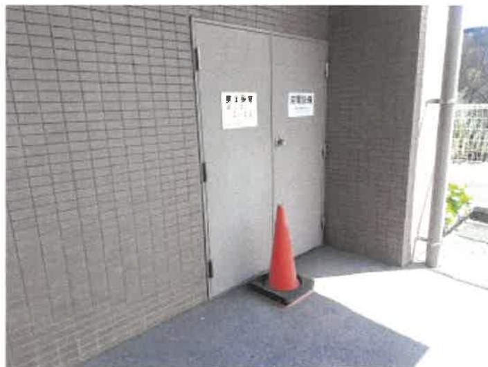
変圧器室の状況
