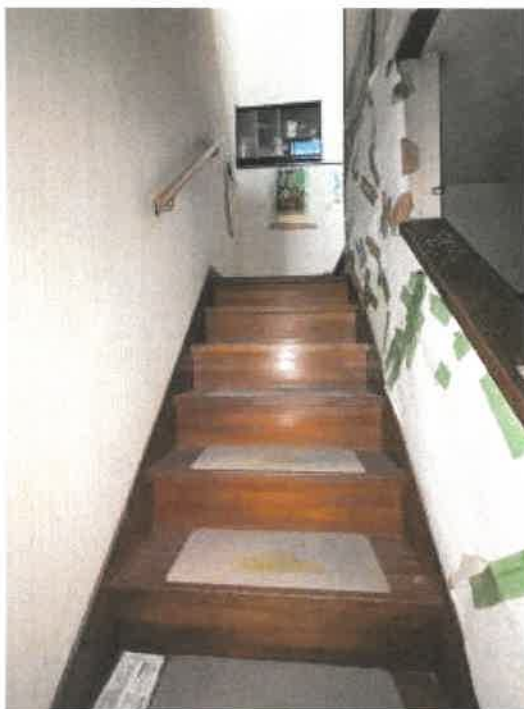
物件2 階段の状況
