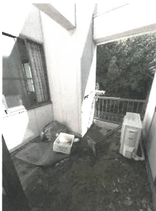
物件2 2階バルコニーの状況
