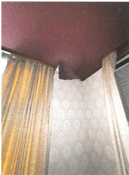
物件 2 2階東側洋室の雨漏り跡の状況
