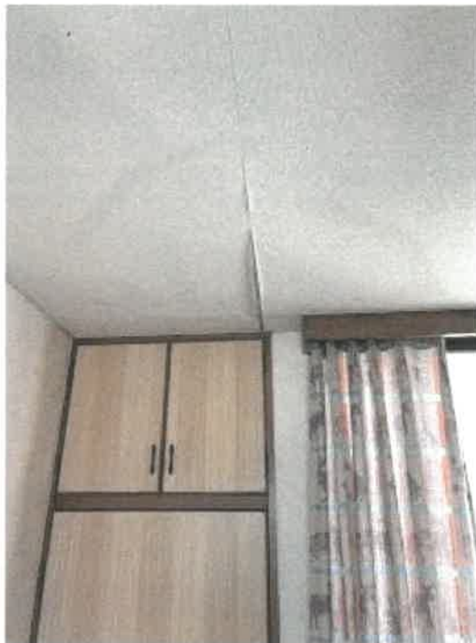
物件 2 2階北側洋室の雨漏り跡の状況
